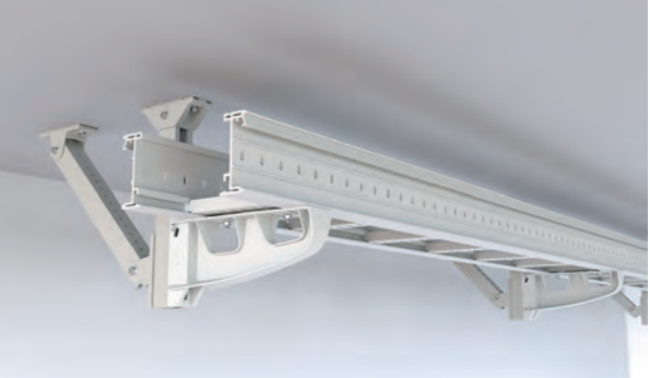
Bajante reforzado con soporte horizontal
