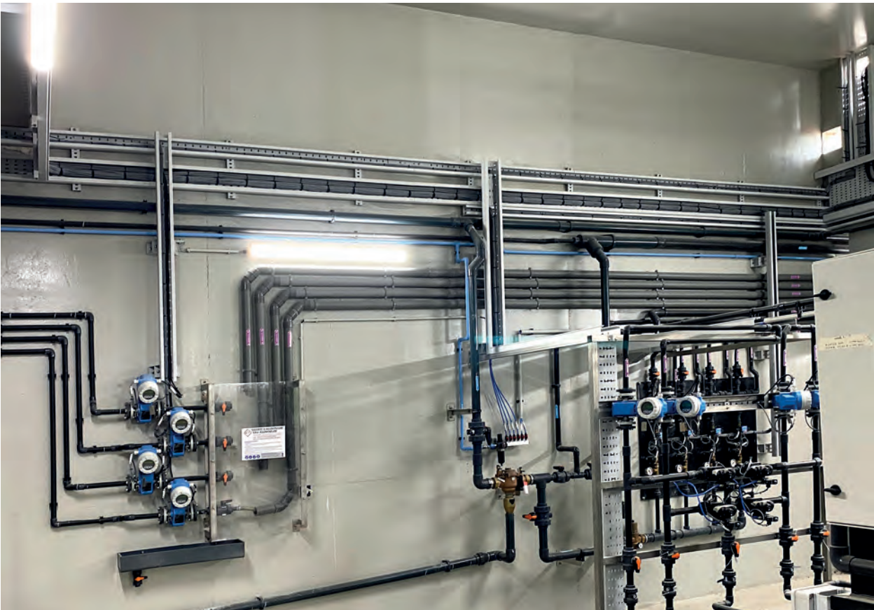
Tratamiento de aguas
