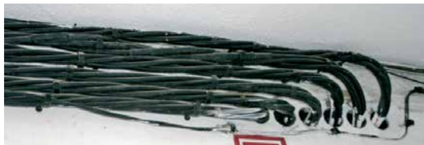
Cables trenzados tipo AL POLIRRET CPRO en redes posadas sobre fachada.
