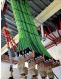
Cables afectados por el CPR.
