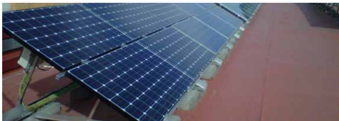
Instalación Fotovoltaica de la Escuela Técnica Superior de Ingeniería y Diseño Industrial de la Universidad Politécnica de Madrid.
